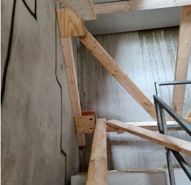
Der er risiko for, at hele bygningen styrter sammen, hvis ikke man afstiver de svært beskadigede mure i trappeopgangen
