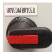
Hovedafbryderen for anlægget findes i teknikrummet
