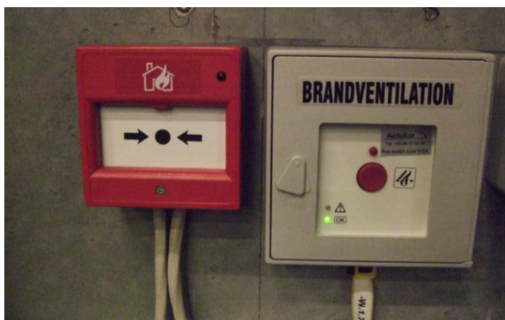
Figur 2: Manuel aktivering af brandventilation og alarmtryk
